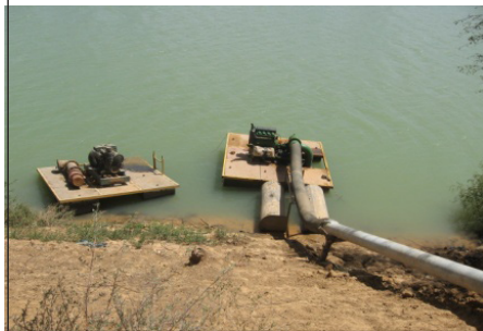
Système de pompage dans la moyenne vallée du fleuve Sénégal
